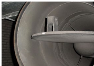
brandklep in (luchtbehandelings)kanalen
