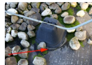
bitumen onder afstandhouder bliksemgeleiding
