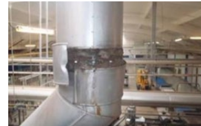
Asbest pakking in gasafvoerkanaal
