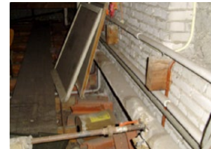
isolatie leidingen en vaten verwarming- of stoominstallatie
