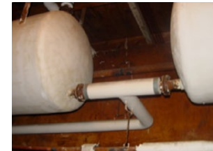
isolatie leidingen en vaten verwarming- of stoominstallatie
