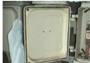
afdichtingskoord in elektrkasten
