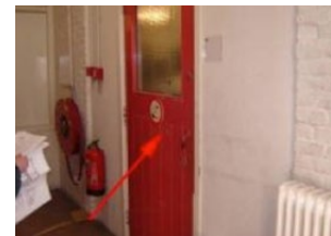
asbesthoudende deur met glas
