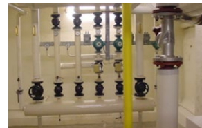
Asbestpakkingen tussen flenzen installatie
