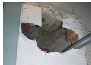
kabeldoorvoer / brandcompartimentering. Beplating heeft een honingraat structuur
