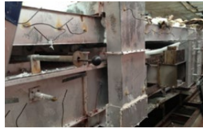
Asbest pakkingen in installatie
